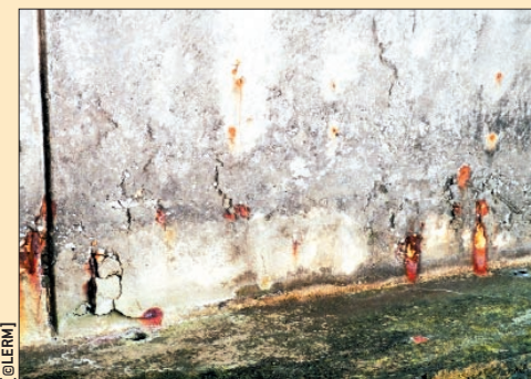
C Corrosion par piqûres liées aux chlorures.
