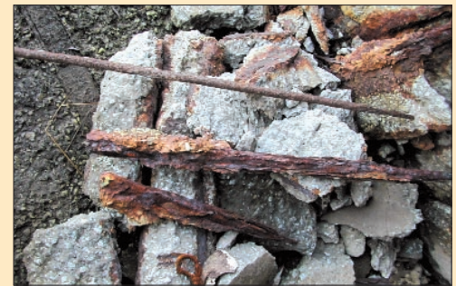
C En se corrodant, les aciers augmentent de volume (en bas), comparé à une armature saine (en haut).
