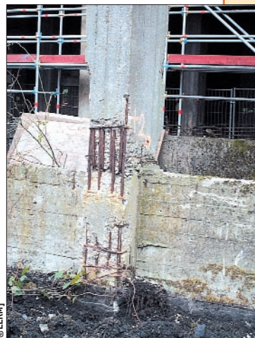
B Corrosion par carbonatation sur un départ de poteau.
