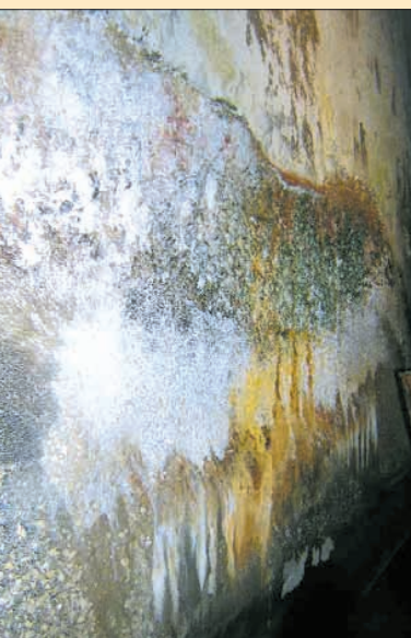
Altération du béton par attaques acide et sulfatique avec traces de corrosion.
