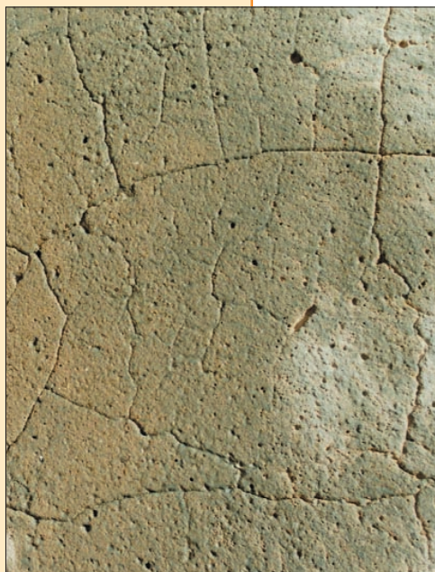
Parement fissuré par un phénomène de retrait accentué par un excès d'eau de gâchage
